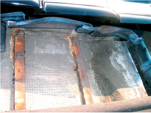
Abb. 1.1-27: Wasser sammelt sich über der Traufbohle und dringt durch Löcher in der Unterspannbahn ein.
