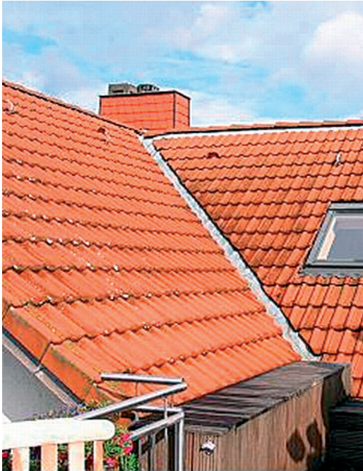
Abb. 1.1-24: Wasserschaden am Drempel, auf den ersten Blick ist die Ursache nicht zu erkennen.
