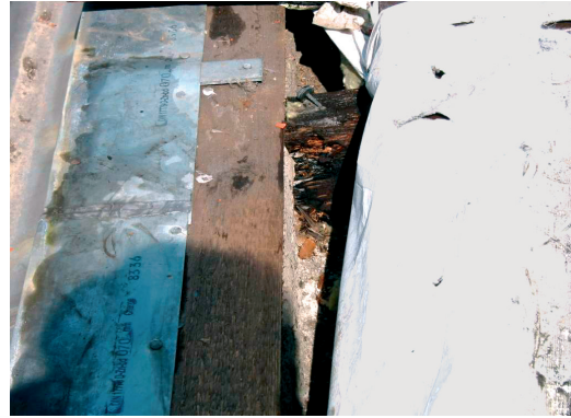
Abb. 1.1-32: Wassereintritt und verfaultes Holzwerk an der Traufe.
