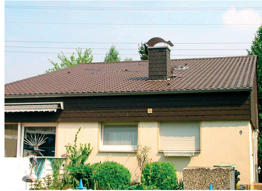
Abb. 1.1-29: Flache Dachneigung birgt Probleme auch an der Dachtraufe.
