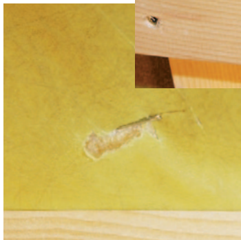
aufgerissene Bahn an Klammer
